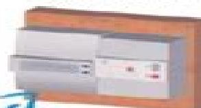
Disjoncteur de branchement
